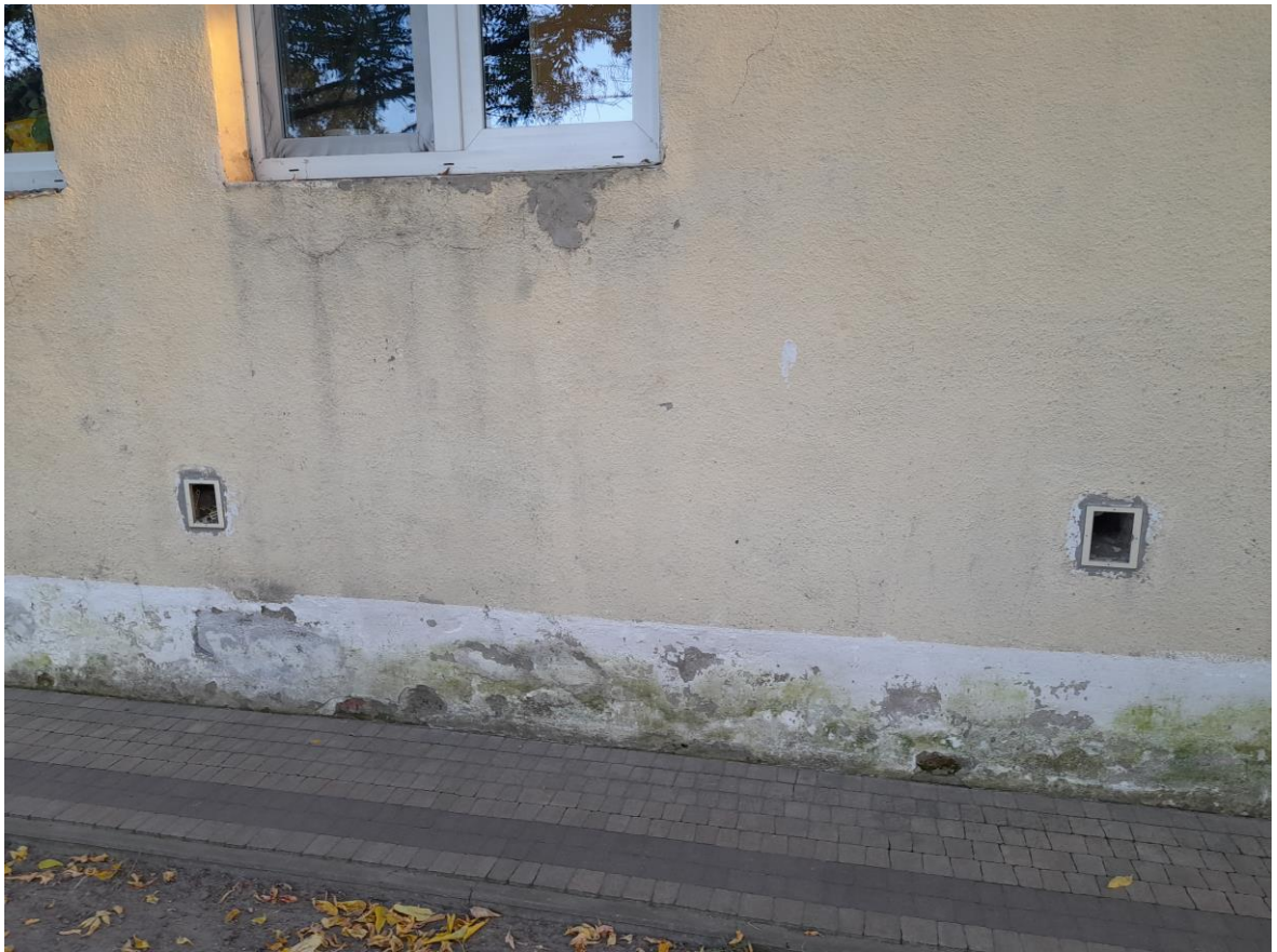
Fot.3 Brakujące kratki w otworach wentylacyjnych
