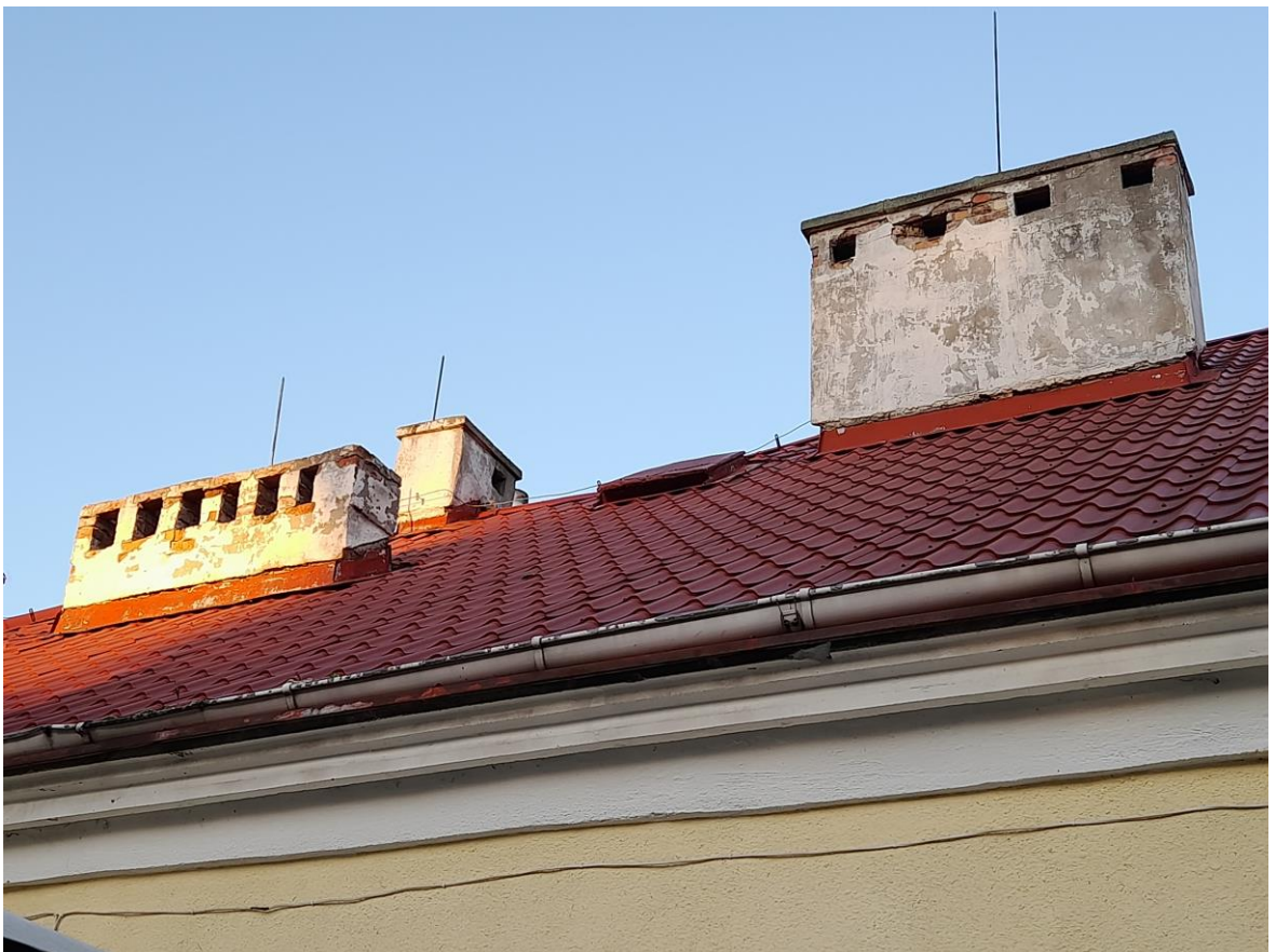
Fot.6 Brak zabezpieczeń otworów wentylacyjnych kominów
