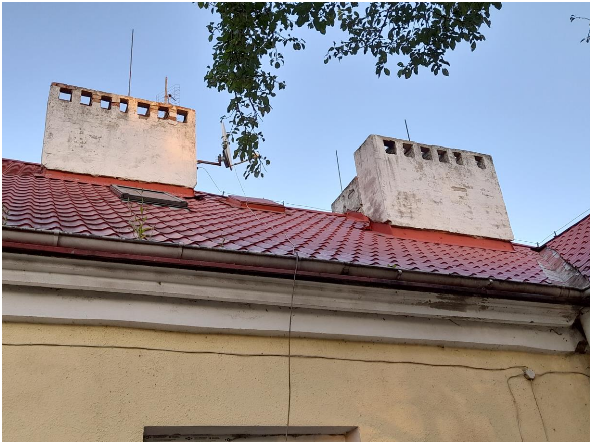
Fot.5 Brak zabezpieczeń otworów wentylacyjnych kominów
